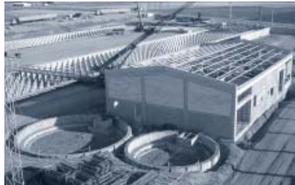
Abbildung 16: Wasseraufbereitungsgebäude und Tankfundamente, im Hintergrund das Kühlturmbecken (KW Ankara)
