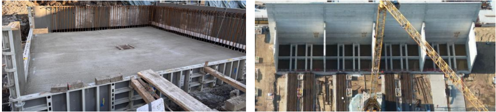
Abbildung 20.4-2: links: Entladetasche; rechts: Auffangwanne für Großtrafo [convex ZT GmbH]
