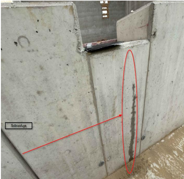
Abbildung 9 Ausbildung eines Trennrisses durch falsche Lage Sollrissfuge in Wand
